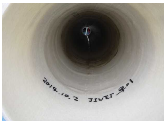
写真 2－2 試験後管内状況
